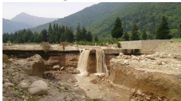
د) آبشستگی در خروجی حوضچه ی آرامش سد
