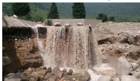
ج) تخریب کامل حوضچه ی آرامش
